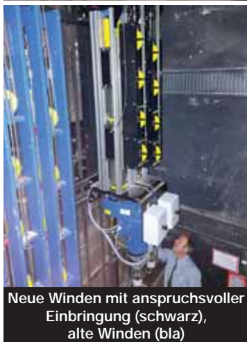
Neue Antriebswinde für die Kurtine (Eiserner Vorhang)
